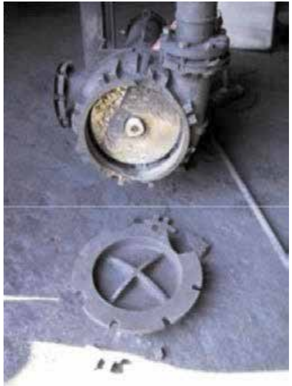
FOT. 2 Pompa po eksplozji i oderwana pokrywa wirnika
