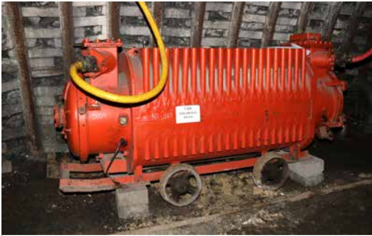
FOT. 1 Działanie hydrogeneratora zostało tak opracowane, że wyprodukowana energia elektryczna zużywana jest w całości przez urządzenia eksploatowane przez pompownię
