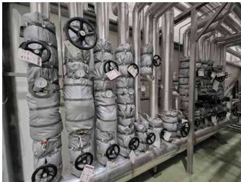
FOT. 1 Zawory i rurociągi c.w.u w izolacji z wełny mineralnej i pokrowców termozolacyjnych
