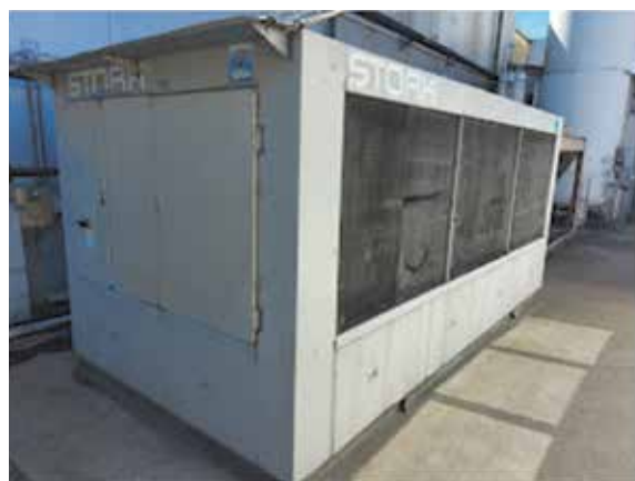
FOT. 2 Widok na stary i nowy chiller wody lodowej
