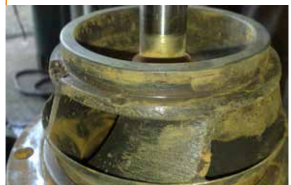
FOT. 1 Erozja kawitacyjna łopaty wirnika pompy (źródło: zasoby własne autora)
