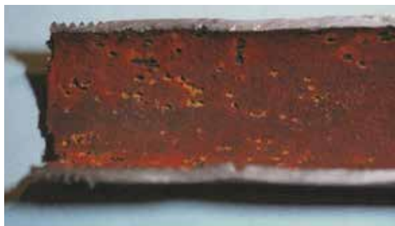
FOT. 1 Przykład powstałej korozji wżerowej
