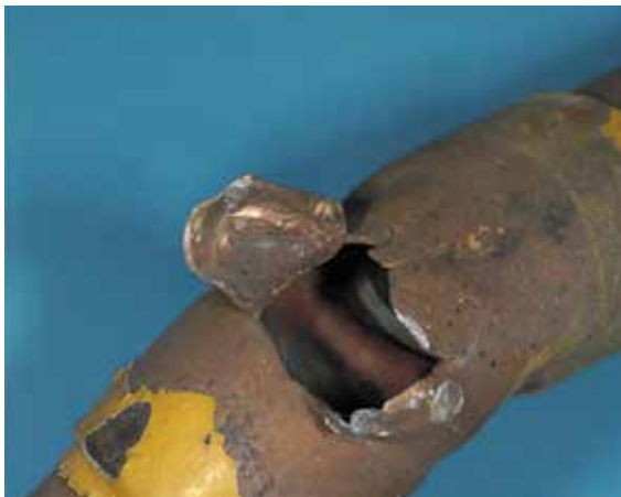
FOT. 3 Rozerwanie rury skorodowanej korozyją wodorową (źródło: zasoby autora)
