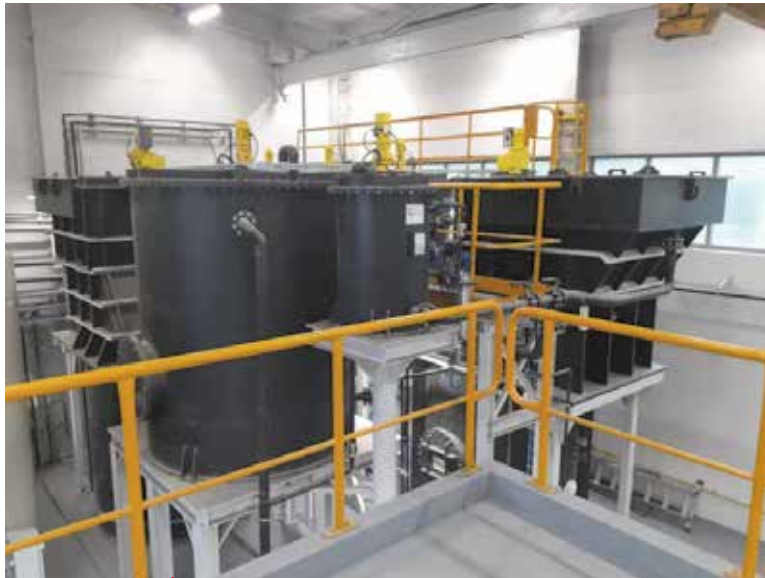
FOT. 3 Urządzenia oczyszczalni ścieków po modernizacji w PEC – Gliwice
